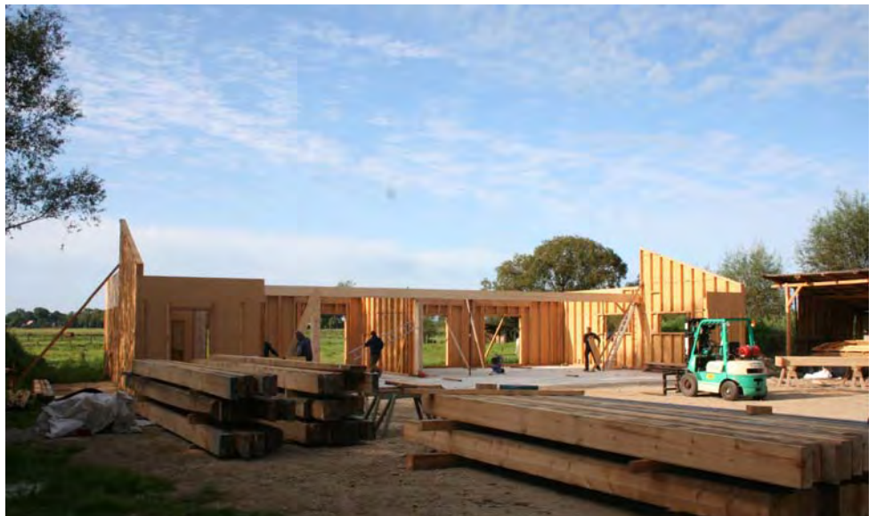
Die Holz-Rahmenbau Elemente der neuen Werkstatt sehen ein bisschen wie Filmkulissen aus.
