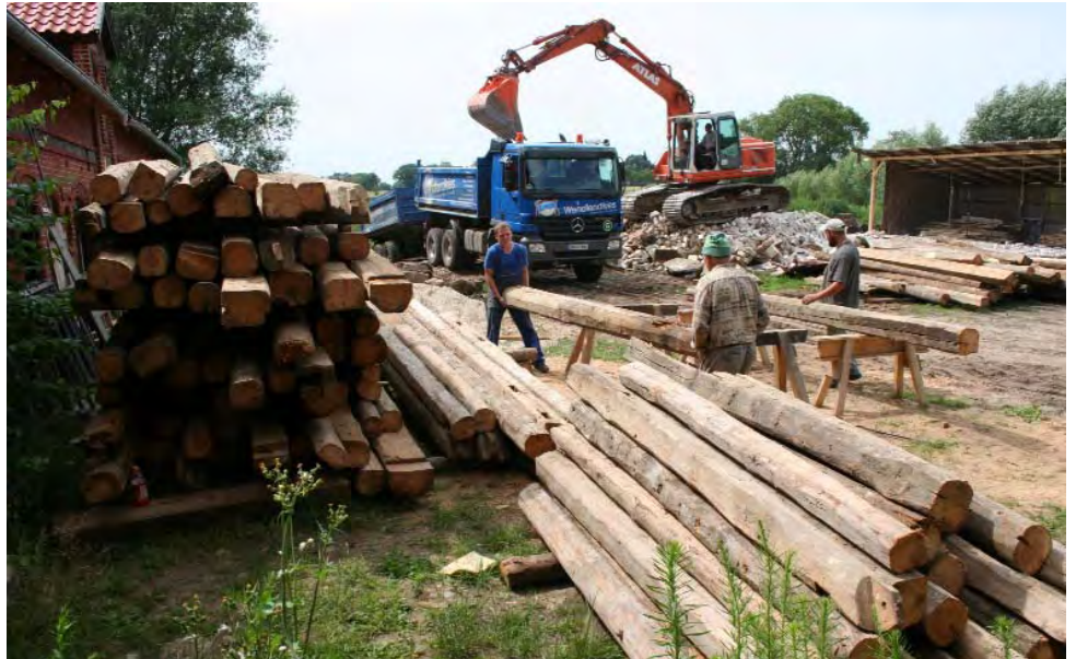
Die Balken des alten Gebäudes werden entnagelt, im Hintergrund die Löcher für die neuen Fundamente gegraben.
